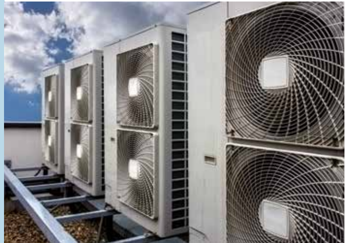
Climatisation d'un immeuble de bureaux à Tresses
