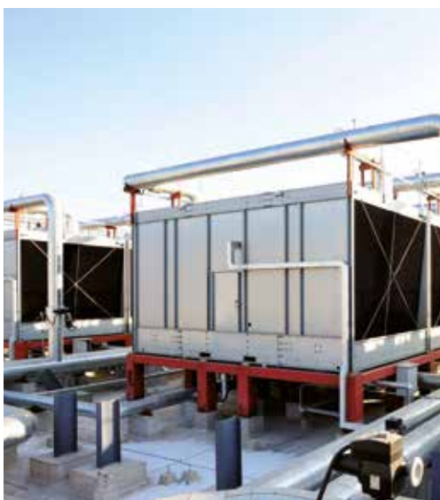
Centrale de production d'eau glacée
